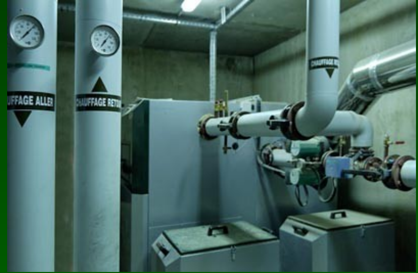
Chaudière à bois (bowling de Val Thorens, maison du tourisme, crèche...)
