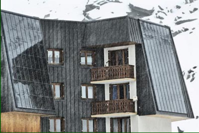
Panneaux pour chauffe-eau solaires (logements sur Val Thorens, ...)
