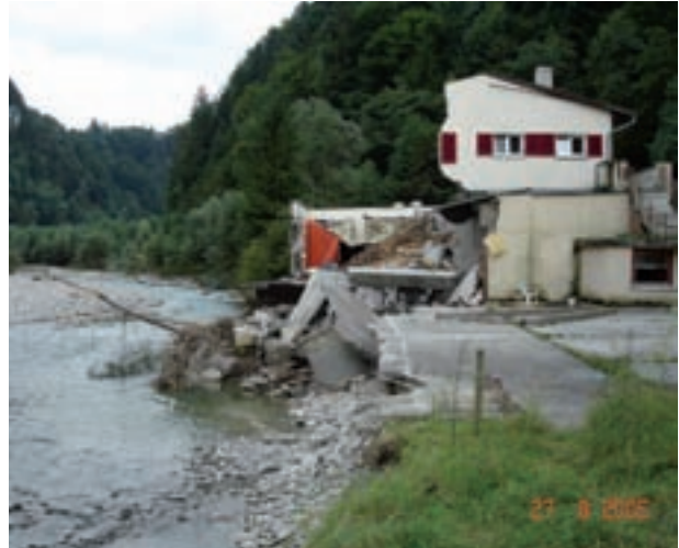
Les dommages provoqués par une crue de la Singine (le 22 août 2005). Dans ce cas, l'eau a besoin de plus de place. Les constructions doivent être déplacées.
